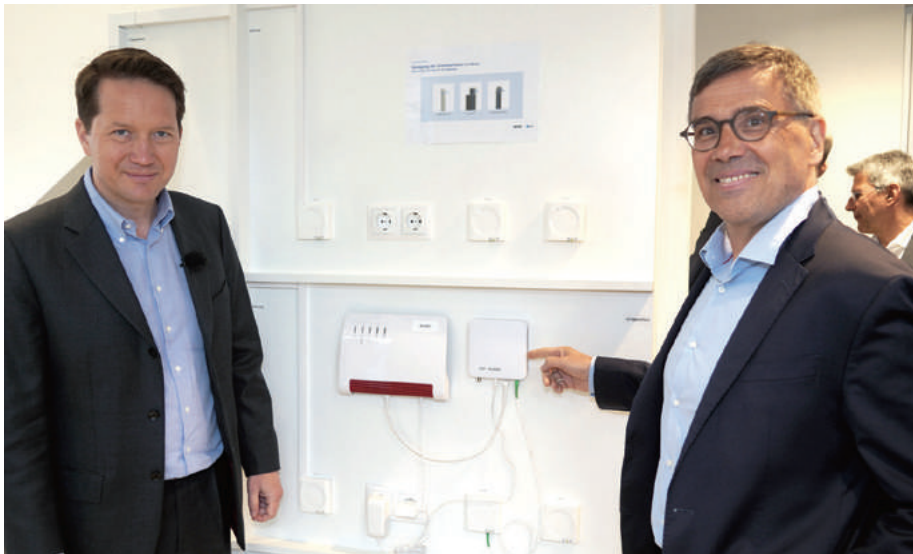
An der Schauwand zeigen Dr. Florian Bieberbach (links) und Nelson Killius wie Umrüstung und Verkabelung im Gehäuse funktionieren. Bild: SWM
